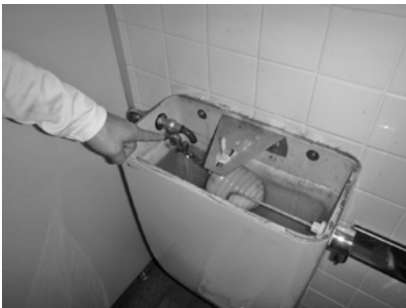
第 7 回市営保育所水廻り点検（崇仁保育所） 和風便器ロータンクボールタップ止水不良
