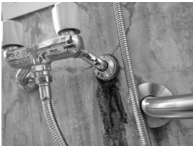
第 8 回市営保育所水廻り点検（改進黨育所） シャワー付地流しの給水側壁中漏水状況
